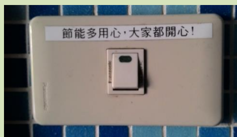
於電源開關張貼節電標語
